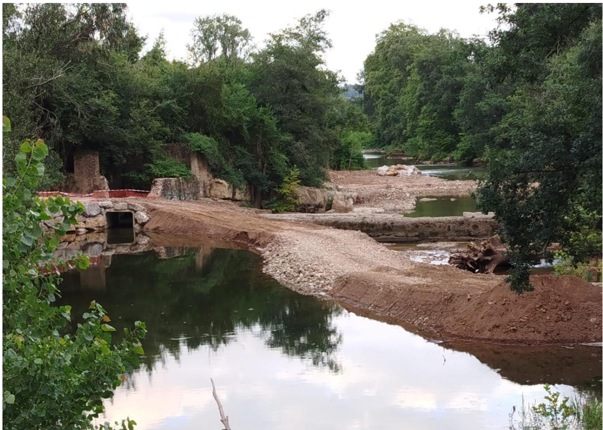
Se inician las obras del nuevo SAIH construyendo un dique que desvíe las aguas hacia el aliviadero abierto en las compuertas del canal de abastecimiento de la central eléctrica Pavón.
