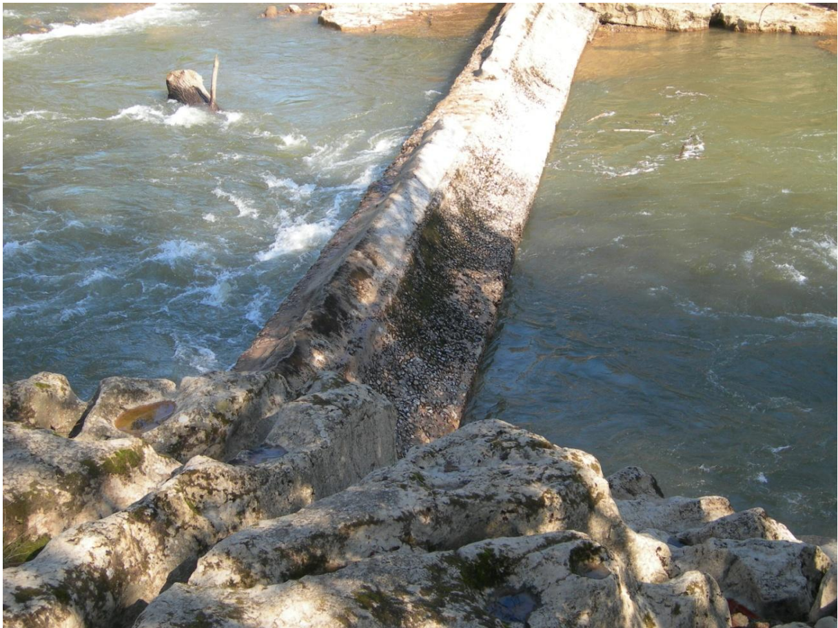
Las fuertes crecidas del río Saja en los últimos años habían ocasionado la rotura del azud en sus cimientos y el agua pasaba por debajo amenazando su estructura.
