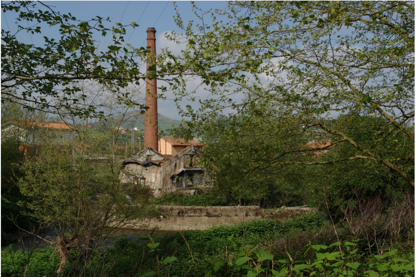
Estado ruinoso de la Central mixta de Pavón
