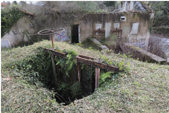
Compuertas de entrada.
